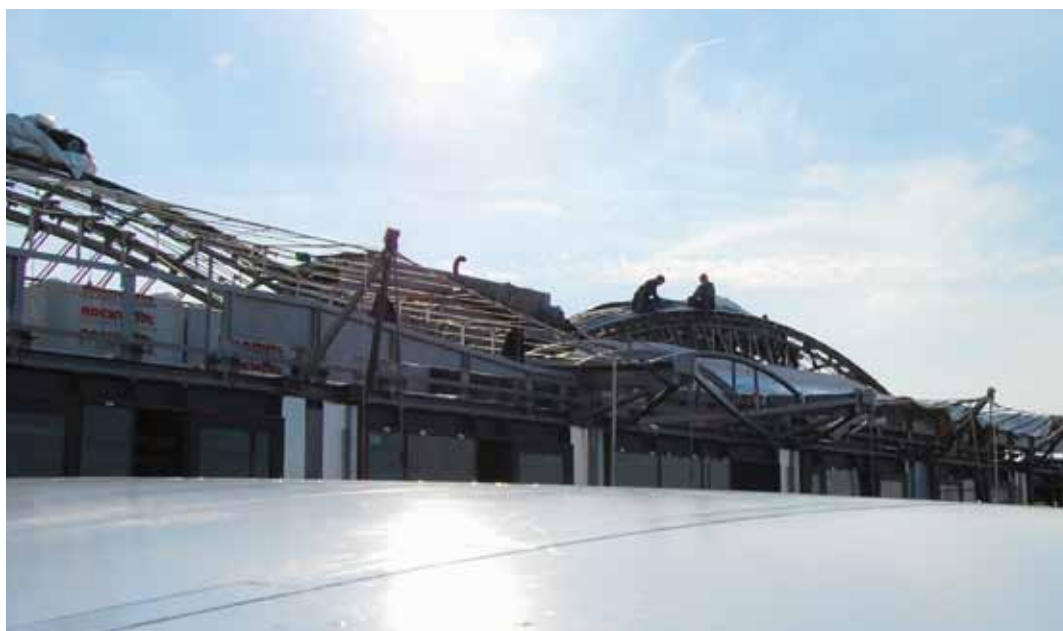
Abb. 1: Installation des Membrandaches auf dem neuen Forschungsgebäude des ZAE Bayern in Würzburg.
