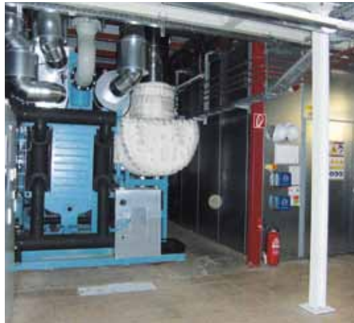
Abb. 1: Zwei-/einstufige Wasser/LiBr-Absorptionskältemaschine (links) und gasmotorisches Blockheizkraftwerk (rechts) für hocheffiziente Kraft-Wärme-Kälte-Kopplung. Die Dimensionen der Anlage im Industriepark in Nabern sind beachtlich (mit freundlicher Genehmigung der Danpower GmbH).
