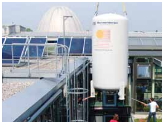
Abb. 4: Installation des optimierten 3. Prototypen eines vakuum-superisolierten (VSI)-Heißwasserspeichers mit 6,5 m 3 Volumen und patentiertem Schichtenlader am ZAE Bayern in Garching. Die Wärmeverluste sind um den Faktor 5 niedriger als bei den besten konventionellen Speichern.
