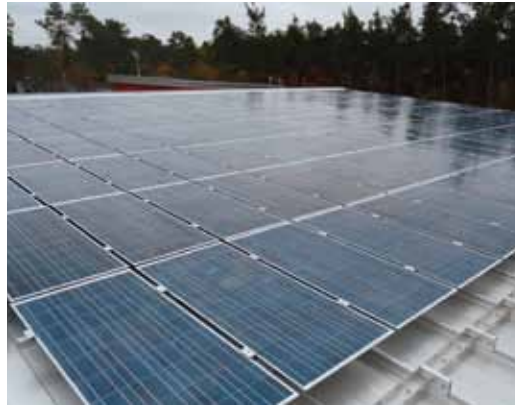
Abb. 2: PV-Module auf dem Dach des ZAE Gebäudes in Erlangen. Fig. 2: PV modules on the roof of the ZAE building in Erlangen.
