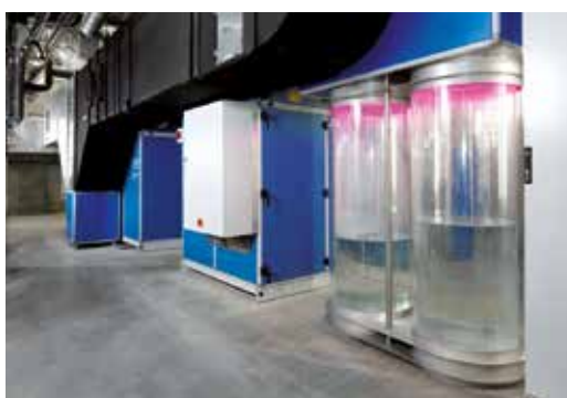
Abb. 3: Speichertanks der Demonstrationsanlage mit konzentrierter und verdünnter Salzlösung. Fig. 3: Storage tanks of the demonstration plant with concentrated and diluted salt solution.
