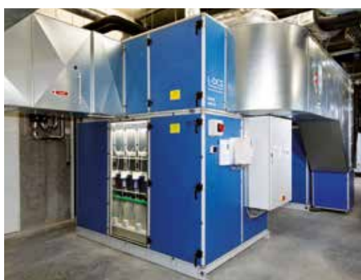
Abb. 3: Lüftungssystem mit sorptionsgestützter Kühlung und Entfeuchtung im Energy Efficiency Center des ZAE Bayern. Die Energiespeicherung erfolgt in einer LiCl-H 2 O Salzlösung. Fig. 3: Open cycle desiccant cooling and ventilation system integrated in the Energy Efficiency Center of ZAE Bayern. Energy storage is performed in LiCl-H 2 O desiccant solution.
