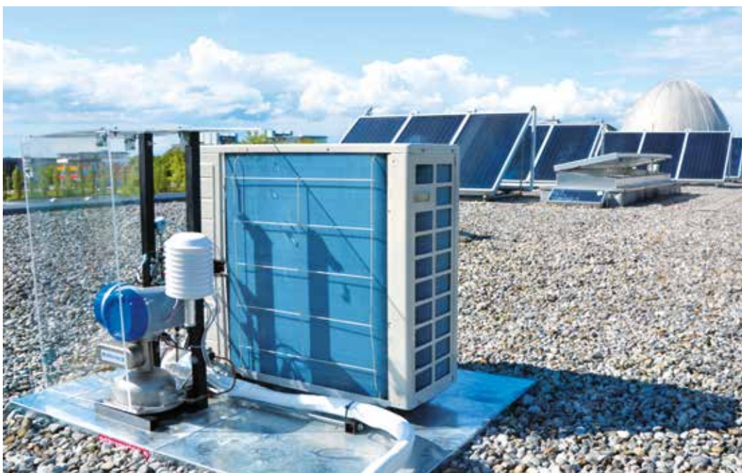
Abb. 1: Vermessung eines Mono-Split Klimagerätes am ZAE Bayern im Rahmen der Feldvermessung. Es werden u.a. Kältemitteltemperaturen, -drücke und -massenstrom gemessen. Im Hintergrund sind die thermischen Solarkollektoren der bestehenden solarthermischen Kühlung zu sehen.
