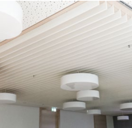
Abb. 1: PCM-Kühldecke in einem Schulungsraum der Landesversicherungsanstalt Münster (© Deerns Deutschland GmbH)
