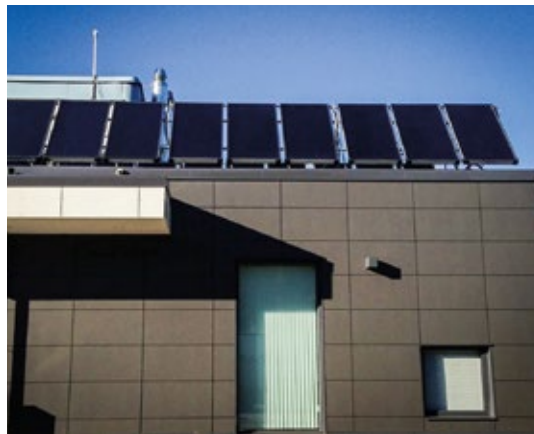
Abb. 2: Pilotanlage zur solaren Klimatisierung in Mikkeli, Finnland mit Flachkollektoren und Glas-Folien-Verbund
