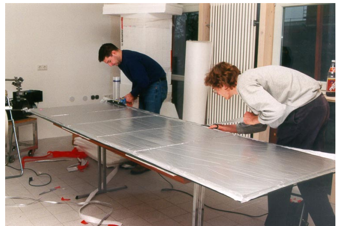
Abb. 2: Herstellung von Vakuumdämmelementen der Größe 290 cm x 90 cm; im Hintergrund: zu dämmende Heizkörpernische
